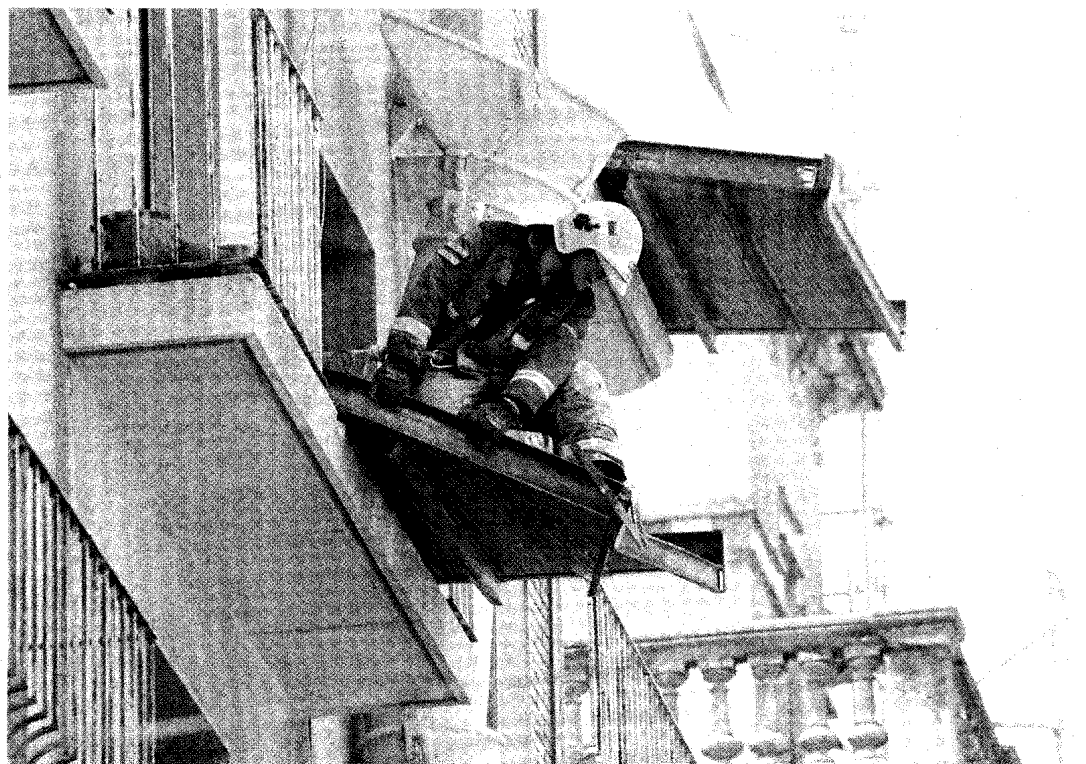
La falta de medidas de seguridad es una causa habitual de los accidentes de trabajo en el sector de la construcción
